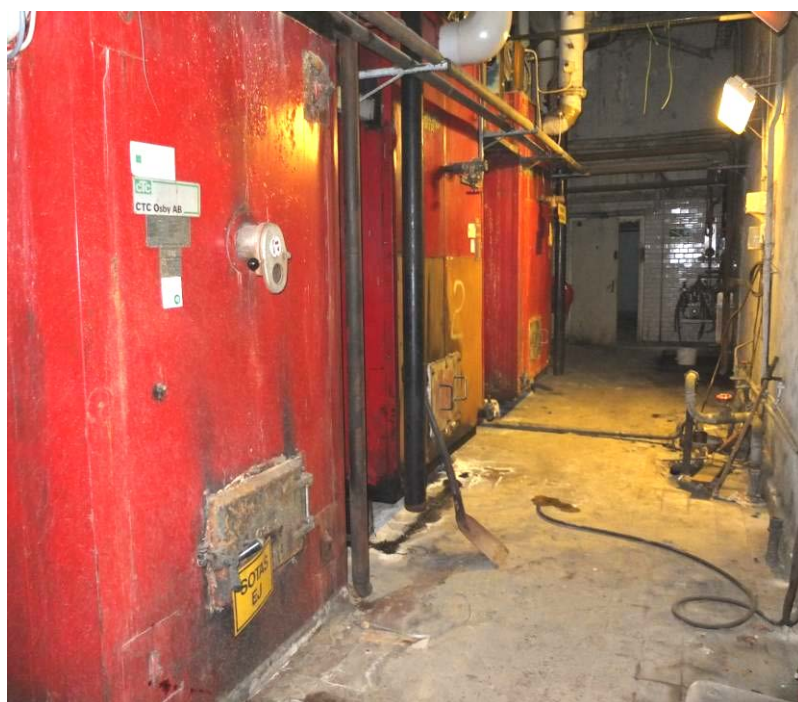
Pannrummet med sina tre stora pannor från 1960-talet. Foto: Fredrika Mellander Rönn
