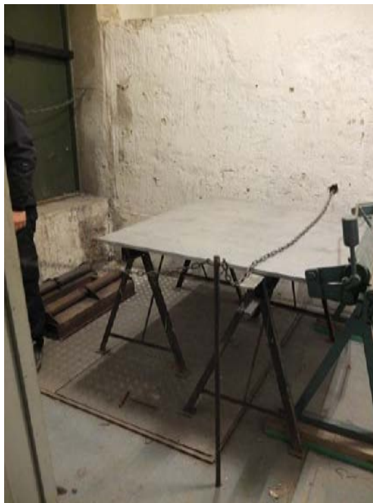
Bränslerum (BV) med lucka i golvet. Kedjor ska förhindra olyckor när luckan är öppen. Foto: Fredrika Mellander Rönn
