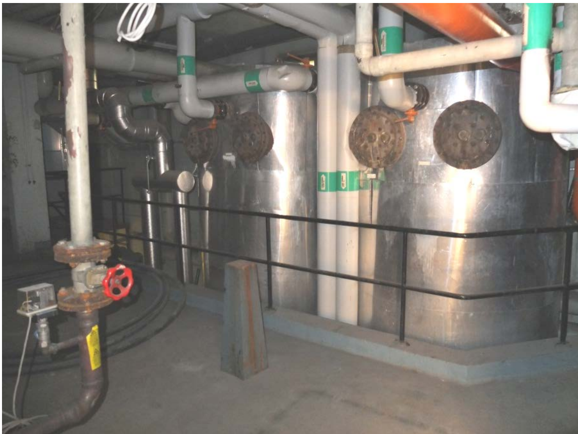
Rum med expansionskär i källarplanets Ackumulatortankar i pumprummets övre del. Foto: Fredrika Mellander Rönn
