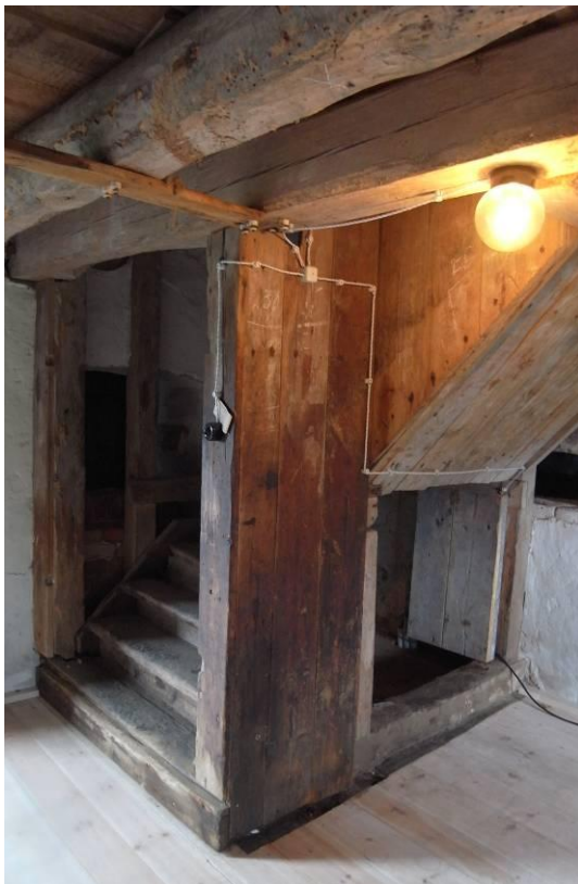
Ny elinstallation av äldre typ har monterats bredvid den gamla av liknande typ
