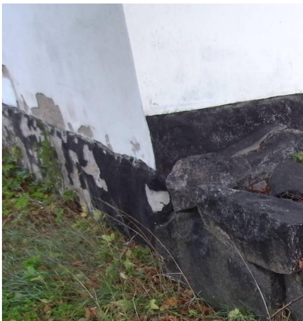
Sydvästra hörnan före restaurering med cementbruk invid mur och en hård, tjock och sugande sockelputs som delvis ramlat bort och transporterat fukt upp i murverket.
