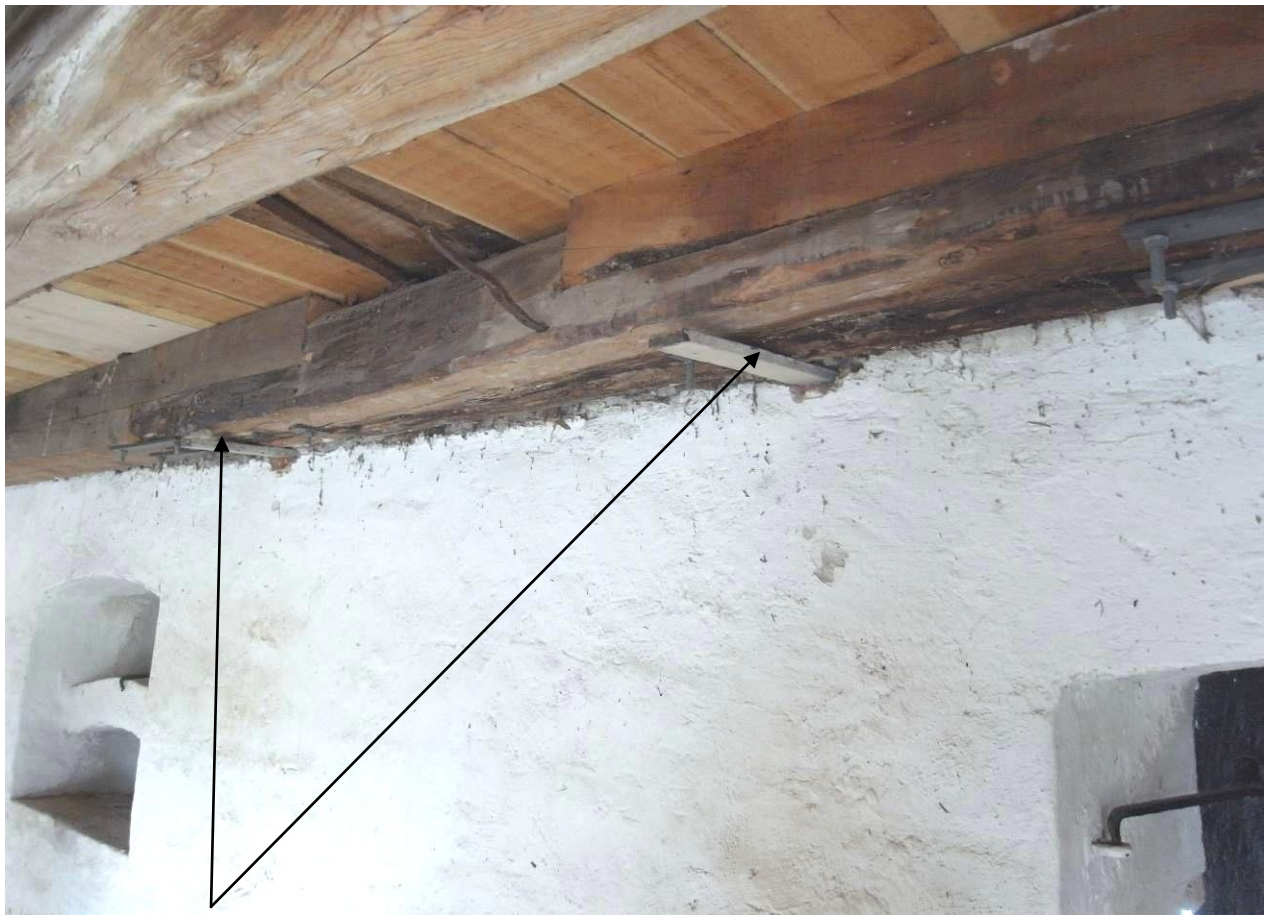
Nya stabiliserande bärstål till golvbjälke med bristfällig lagning från 1996. Synlig från entréplan invid norra väggen.
