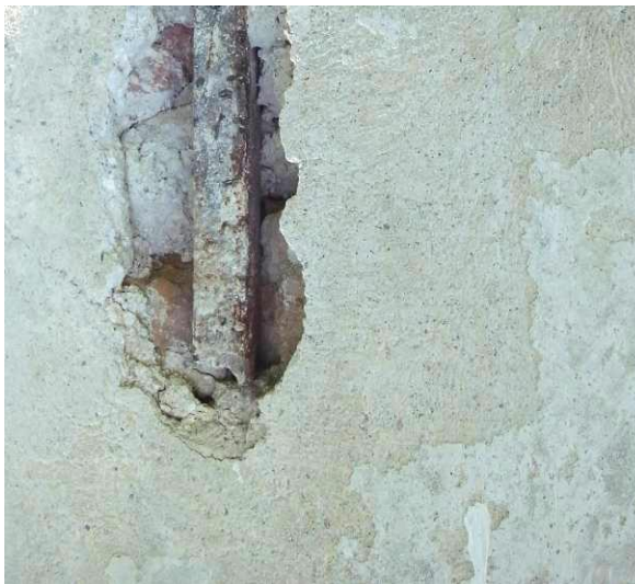
Äldre putslager utfört i ett påslag med rikligt med kalkklumpar samt inmurat ankarslut av smide. På fasad mot väster.
