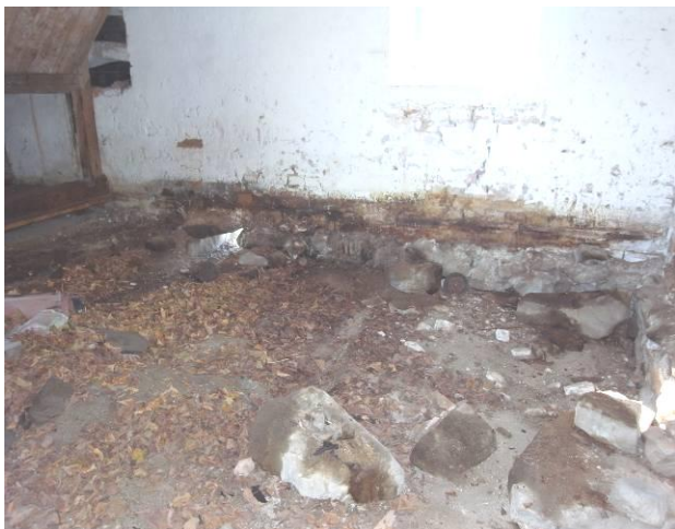
Bjälklaget rivet och spillolja synlig på väggen
