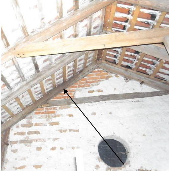
Västra gaveln före åtgärd där ankarjärn saknas på vänstra sidan. Här syns även det gamla tegeltaket (tv) och nya taket (th) med ny understrykning.
