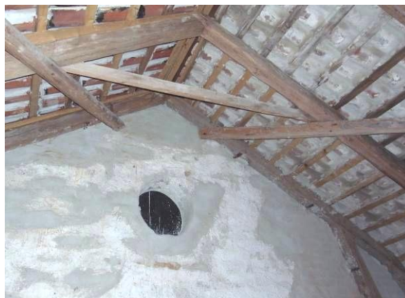
Vindens gavelytor har avfärgats så att ett enhetligt intryck av väggen erhålls.
