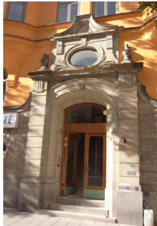
Portens sandstensomfattning har vittringsskador och vissa delar behöver ersättas och stenyrtorna konsolideras. Nytt entréparti av ek.
