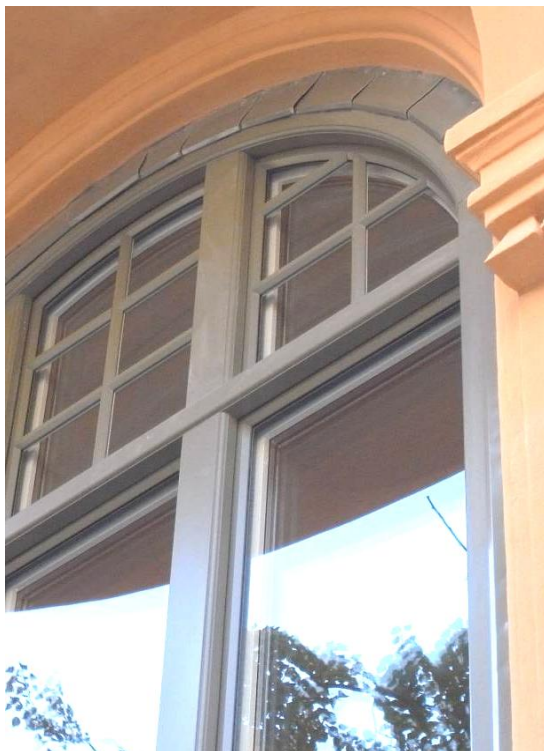
Rundbågevälvd del mot gatan, Nya instickskarmar med spröjs i övre bågar. Plåten ser ut att vara på väg att lossna. Ska åtgärdas.
