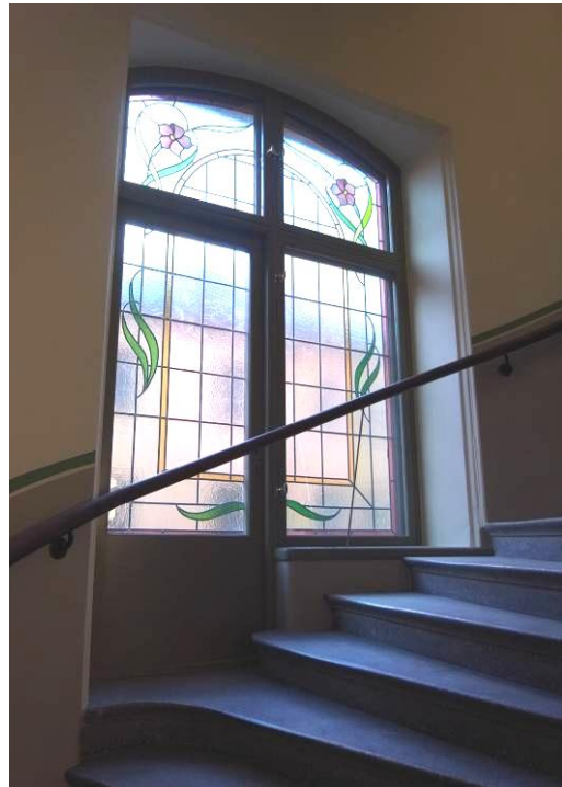
De blyspröjsade och dekorerade jugendglasen i trapphuset mot gatan är lagade och kompletterade så att hela trapphuset är komplett
