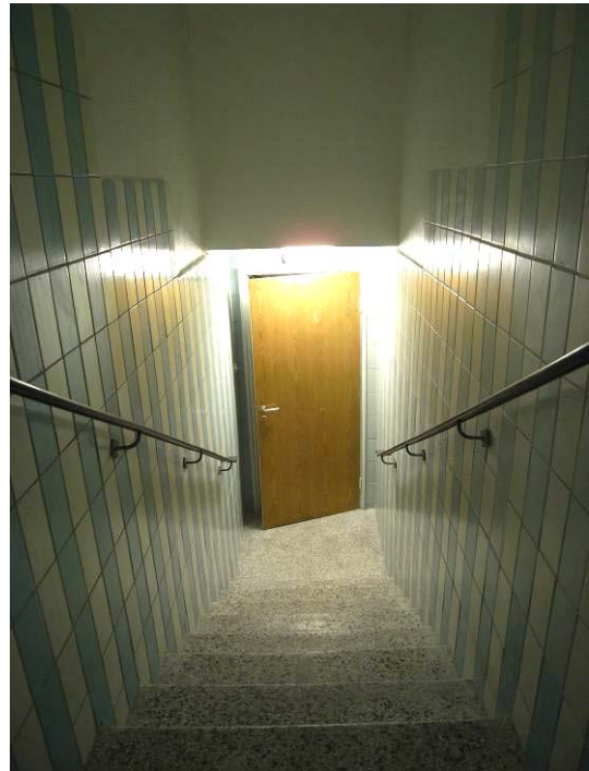
Återställd herrtoalett efter golvkollaps
