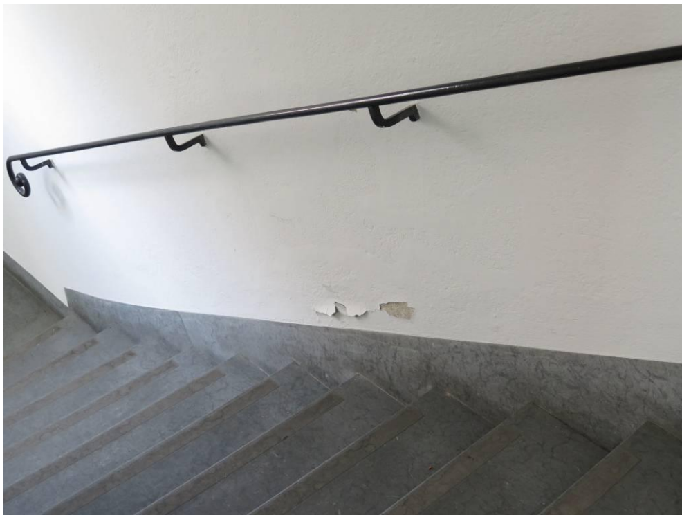
I trapploppen finns ursprungliga smidesräcken och skursocklar av kalksten. Skador i putsen på grund av olämpligt färgmaterial
