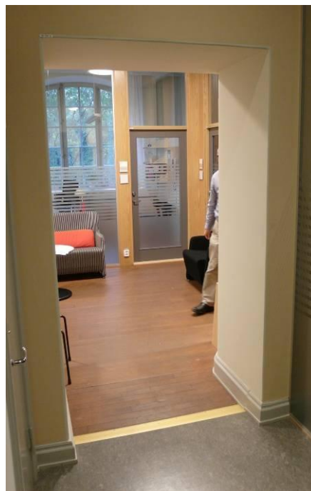
Muröppning utförd och bearbetad under tidigare ombyggnadsskede. Foder saknas och uthörn av puts som känslig murdetalj..
